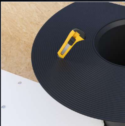
Podcięcie gilzy od zewnętrznej strony parapetu.
